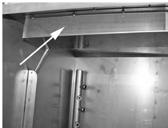
Afbeelding 41 EcoExchanger zoals zichtbaar in de machinecabine
