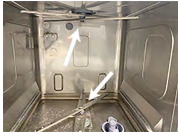
Photo 15 Lavage et rinçage des bras
