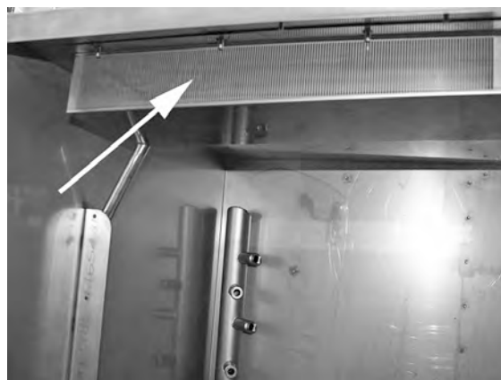
Bilde 41 EcoExchanger som vist inni maskinskapet
